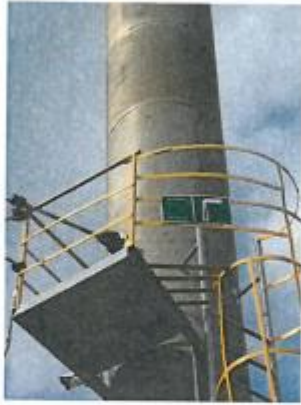
锅炉废气(处理后)排放口 (DA024)
